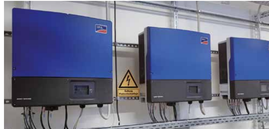
Wechselrichter der Photovoltaikanlage Inverter for the photovoltaic system
