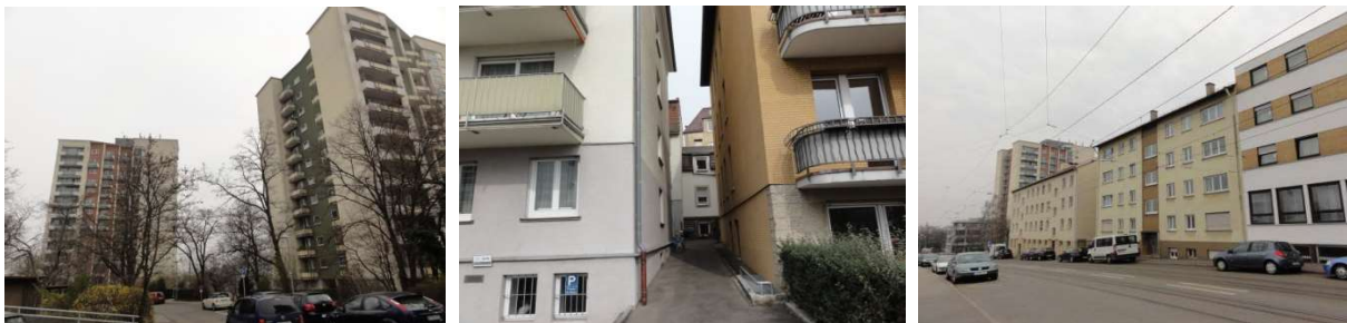
Defizite im Wohnbaubestand im Quartier Friedhofstraße, Wolframstraße südlich Heilbronner Straße
